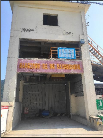
转运间（卷扬机房）
