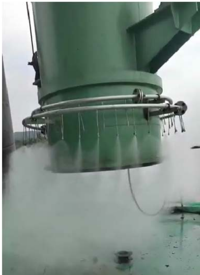
图 7.2-1 变更后 4#泊位装船机雾化喷淋系统
